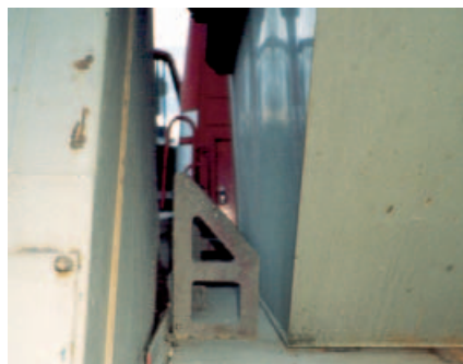
Formschlüssige Sicherung eines Absetzbehälters zur Seite. Der Abstand zu den Anschlägen ist nur gering und kann akzeptiert werden.
